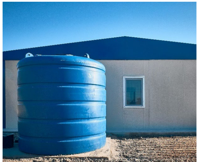
Figure 2 : Réservoir de stockage d'eau sur un socle de ciment alimentant un emplacement temporaire.
