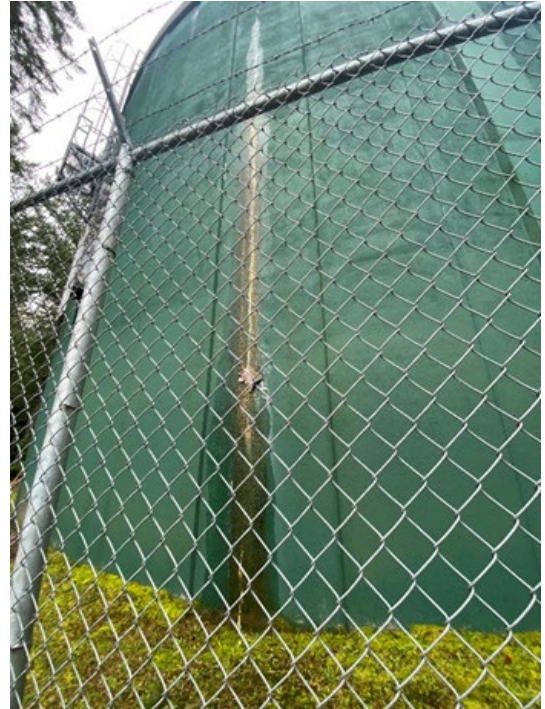
Figure 5 : Grand réservoir municipal avec une fuite et de la corrosion à sa surface. (Photo : N. Elmieh)
